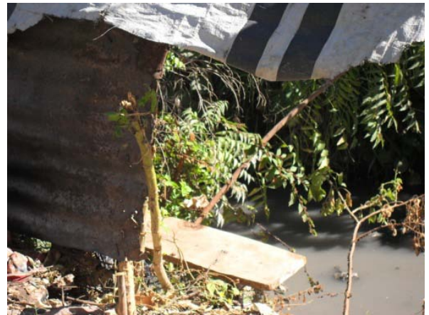
Toilette en suspens – Camp SAC
