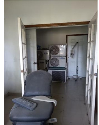
Climatiseurs non encore installés
